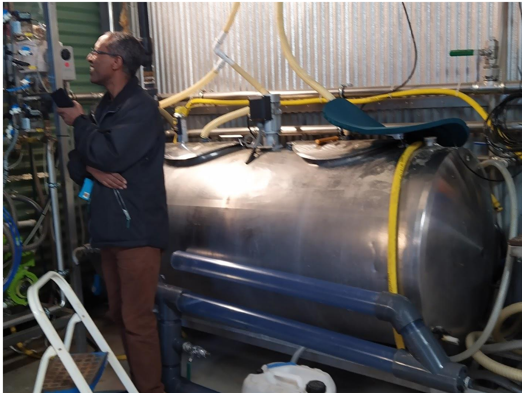
Biogassreaktor for produksjon av energi og gjødsel
